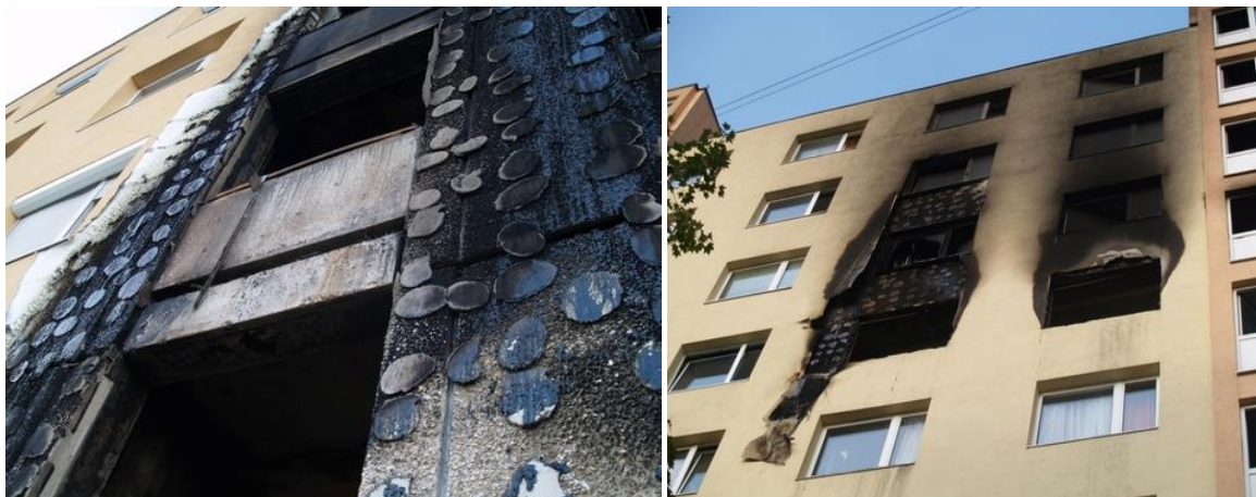
Rys. 2 Widok budynku po pożarze (przykład rozprzestrzenianie ognia, do którego przyczyniło się nieprawidłowe przyklejanie płyt styropianowych) źródło: nowoscibudowlane.com.pl.
